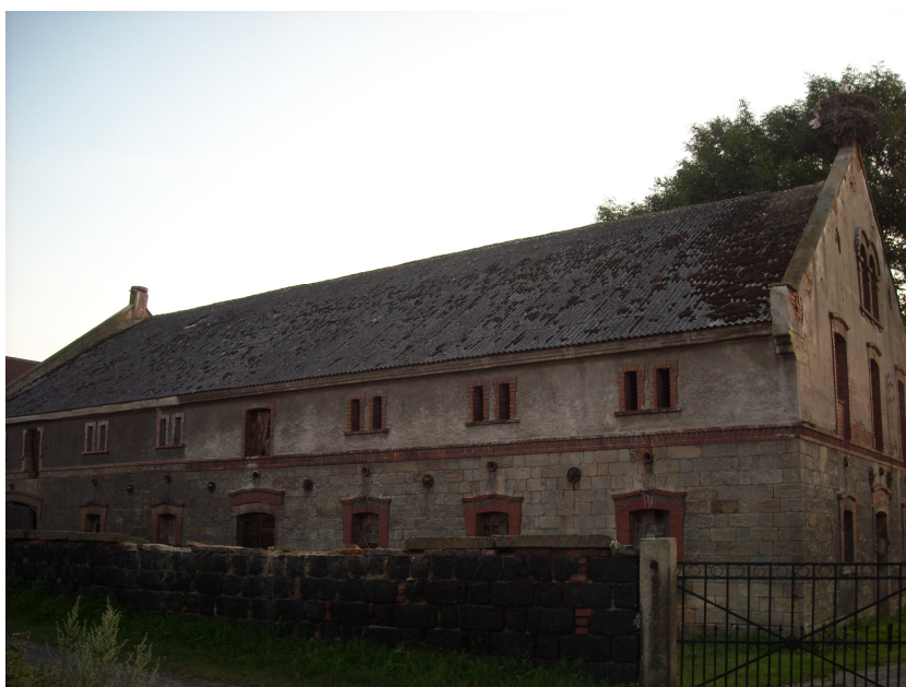
Fot. 6. Budynek gospodarczy pokryty płytami cementowo-azbestowymi – Rokitnica 28.
