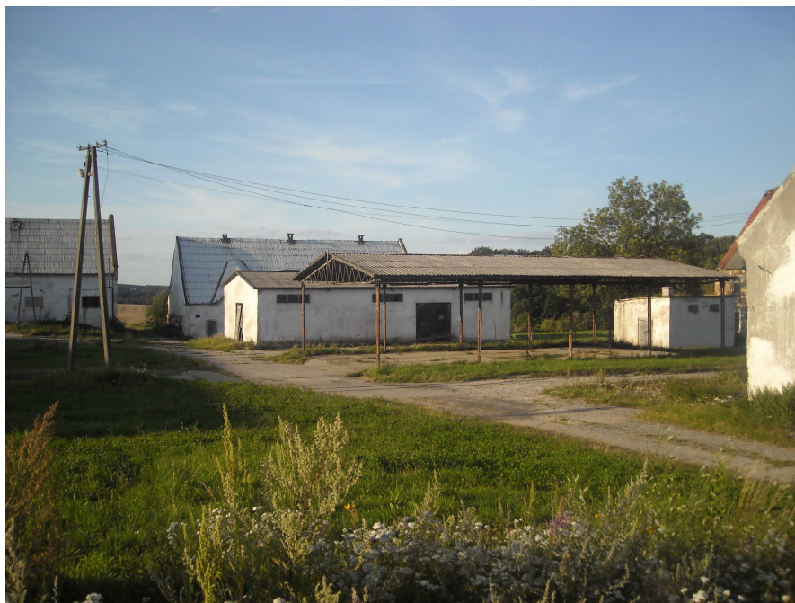
Fot. 1. Budynki gospodarcze pokryte płytami azbestowo-cementowymi w miejscowości Łaźniki.
